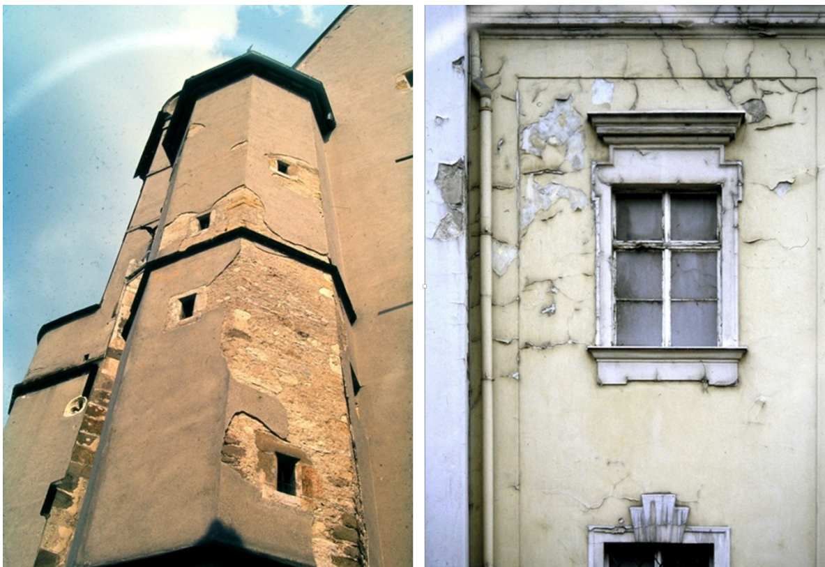
20 Maria Straßengel/Steiermark, Wallfahrtskirche Mi. 14. Jh., Westfassade, Putzreparatur in den dreißiger Jahren (1934?) mit hartem Zementputz. An der Südfassade des Treppenturms besonders starke Schäden 21 Wien, Schottenkirche, Südfassade, 1648/1893, Detail. Die Schottenkirche in Wien wurde in den siebziger Jahren des 20. Jahrhunderts mit zu hartem Kalk-Zementputz und einer Dispersionsfarbe erneuert und zeigte durch Scherspannung bald entsprechend Risse, vor allem an der Südfassade. Durch eine undichte Dachrinne sind Salze an der Oberfläche konzentriert. Die Salze zermürben die Oberfläche des Putzes. Foto I. Hammer ca. 1980
