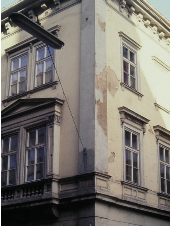
24. Klagenfurt, Fassade eines mit Dispersionsfarben gestrichenen Hauses. An der Südwestfassade sind die Schäden durch thermische Dilatation stärker als an der Nordwestfassade. Foto Ivo Hammer 1980
