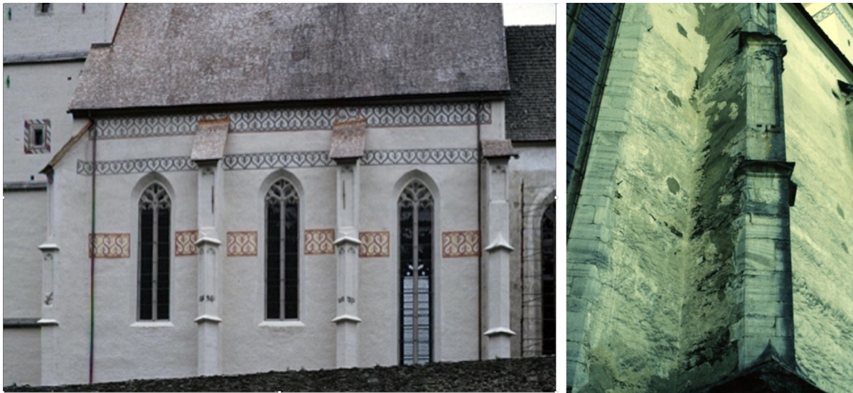
15. Grades/Kärnten, Filiationkirche 15. Jh.; a) Südfassade Langhaus und Westturm, von Kirchenmaler Walter und Werner Campidell in traditioneller Kalktechnik restaurierte Fassade, 1986.; b) (16) Chor, Südfassade: Die Netzriegellöcher wurden bei späteren Reparaturen wiederverwendet. Fotos I. Hammer 1987
