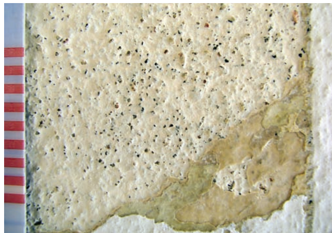
14. Brno (Czechy), Dom Tugendhatów, 1930, Ludwig Mies van der Rohe, elewacja południowa, II kondygnacja, powierzchnia w trakcie czyszczenia wykonywanego przez konserwatora-restauratora przy użyciu mikrodluta pneumatycznego: oryginalna powierzchnia hydraulicznego tynku wapiennego wygładzona deską drewnianą i przemyta bardzo rzadką farbą wapienną pigmentowaną piaskiem mułowym; trzy brązowe wapnowania, zmienione; ostatnia warstwa cementowo-żywiczna z 1985 r. (fot: Ivo Hammer 2011)
