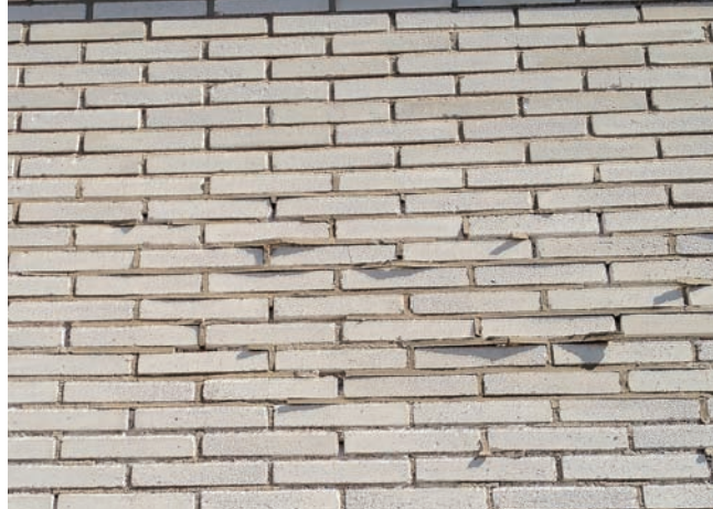
6. Helsinki (Finlandia), Lotnisko Malmi (Malmin lentoasema), Dag Englund, 1935-38. Uszkodzenie łączeń w wyniku naprawy materiałem wodoodpornym (cement portlandzki?) (fot. Ivo Hammer 2012)
