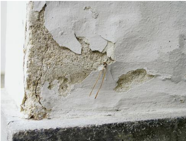
1 Dessau, Meisterhaus Feininger (1926), Fassade, Detail: Schäden verursacht durch inkompatible Beschichtung von 1994
