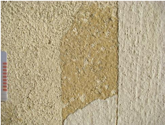
2 Brünn, Haus Tugendhat, obere Terrasse, Südostfassade, Sondierung: (li.) originale Oberfläche, (Mitte) 2 vergipste Kalktün- chen, (re.) Zementschlämme und Kunst- harz-Sand-Tünche von 1985
