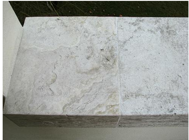
3 Brünn, Haus Tugendhat, obere Terrasse, Südostfassade, Travertin-Abdeckung der Brüstung: (li.) Probe der Reinigung mit Ammoniumcarbonat, (re.) aktueller Zu- stand (Reinigung mit Wasserdampf)
